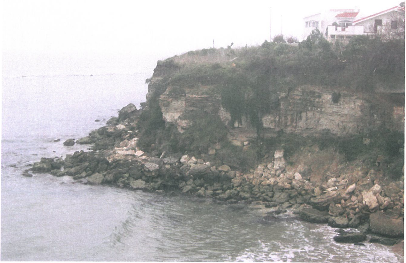
Particolare stato di dissesto rilevato da sopralluogo nella costa meridionale di Trani
